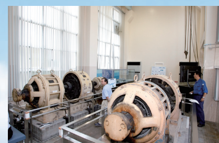
勝興橋を動かしていた発電設備
